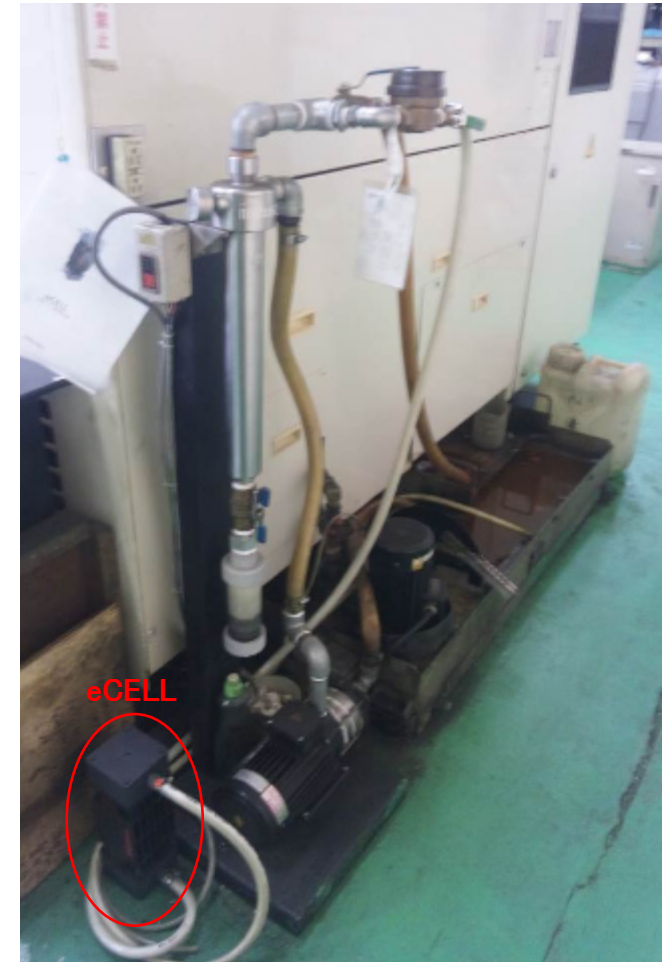
eCELL接続状況
